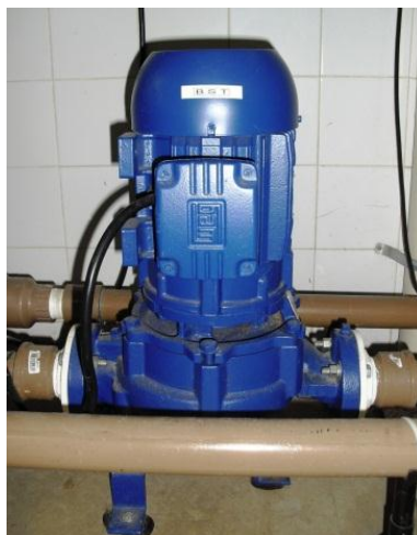
Figura 3.2 - Booster instalado na rede com entrada e saída em linha
