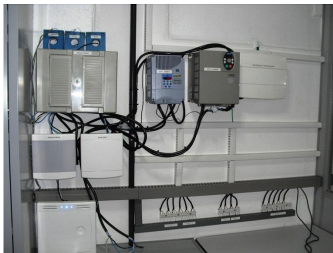
Figura 3.14 - Quadros elétricos e conversores de frequência
