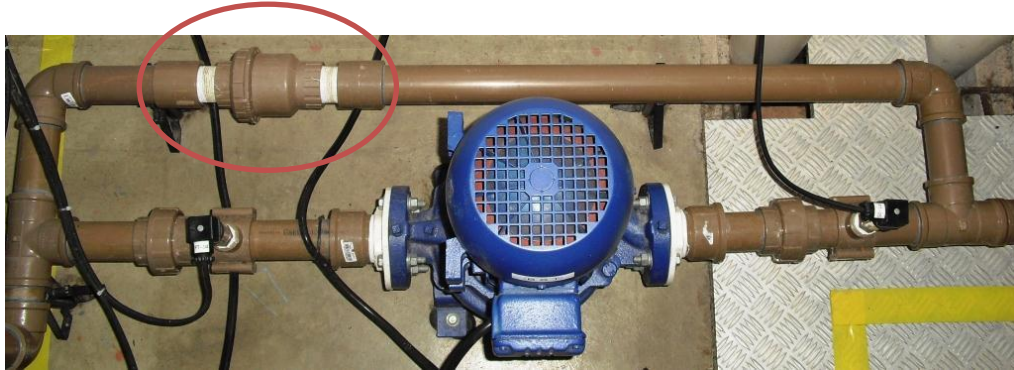
Figura 3.13 - Detalhe do bypass realizado para o booster no ramal da zona alta
