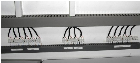
Figura 3.15 - Detalhe do barramento executado com barras de sindal e canaletas
