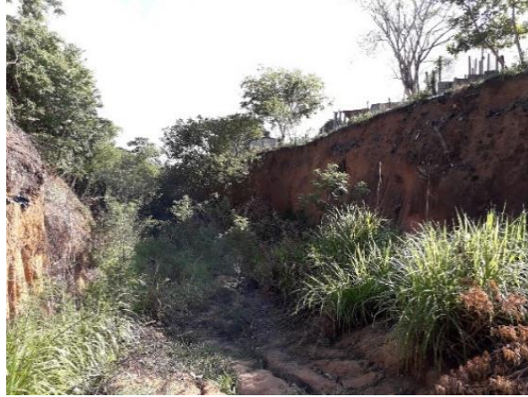
Figura 60 - Interior da erosão (início). Fonte: Registro feito pelo autor (2019).
