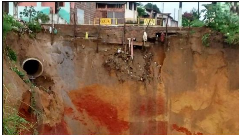
Figura 19 - Boca de lobo que despejava esgoto abaixo da praça. Fonte: www2.pbagora.com.br (2016).
