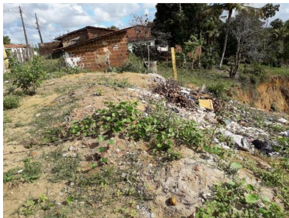
Figura 23 - Presença de residências no entorno da erosão. Fonte: Registro feito pelo autor (2019).
