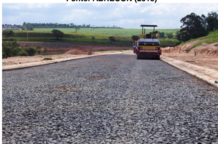
Figura 28 - Uso de agregados reciclados de resíduos da construção civil na pavimentação. Fonte: ABRECON (2018)
