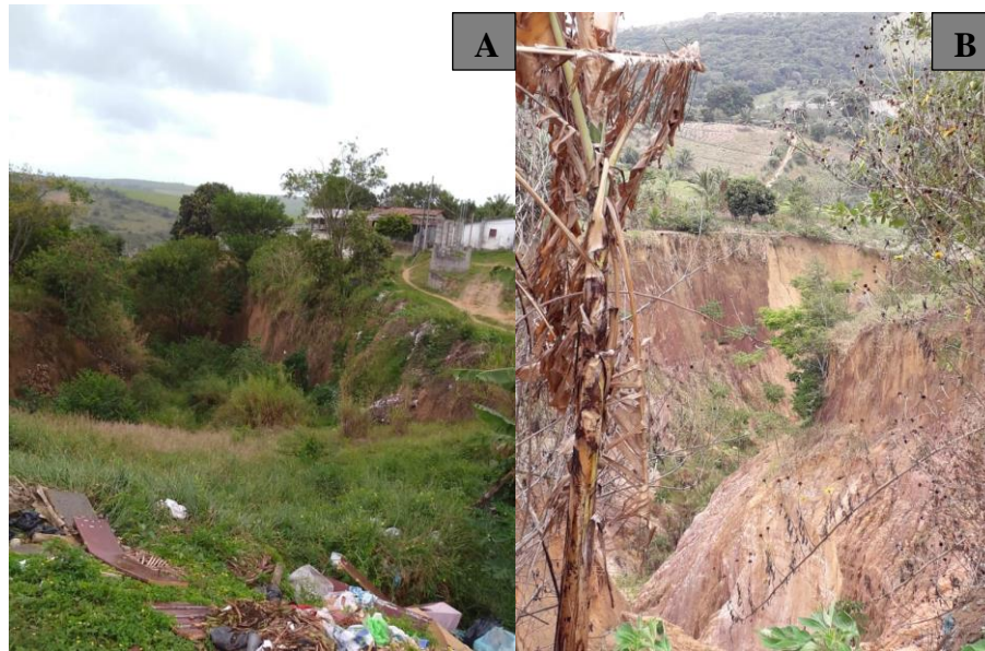
Figura 8. Feições Erosivas no Distrito de Mata Redonda. (A) Vista Sudoeste da Ravina; (B) Vista Sul da Ravina. Fonte: Registro feito Autora, 2018
