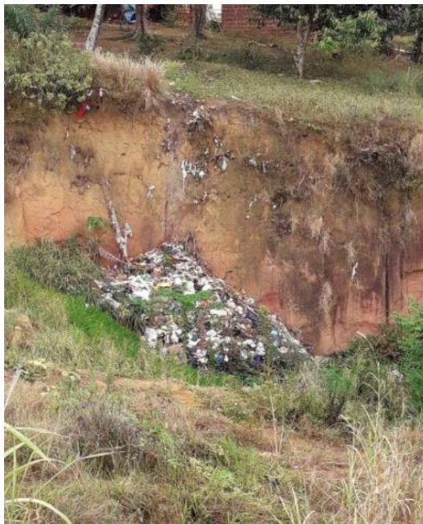
Figura 16. Deslizamento de encosta com acúmulo de lixo. Fonte: Registrado pela Autora.
