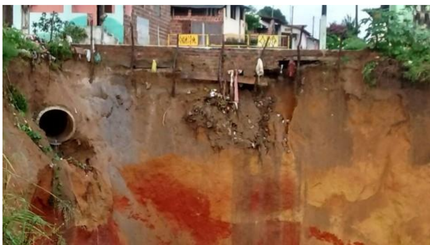
Figura 17. Feição Erosiva da erosão de Mata Redonda antes da intervenção. Fonte: Portal do Litoral PB, 2016
