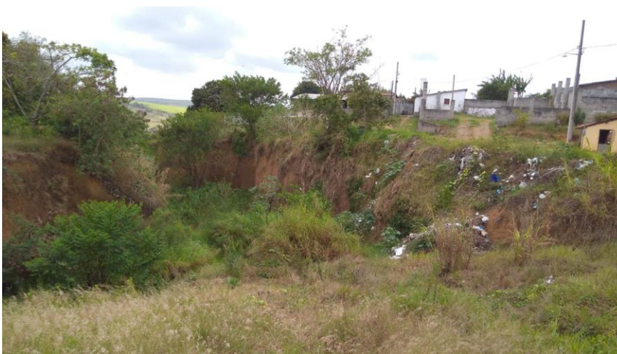
Figura 18. Feição Erosiva da Ravina de Mata Redonda depois da intervenção realizada pela Prefeitura. Fonte: Registrado pela Autora.
