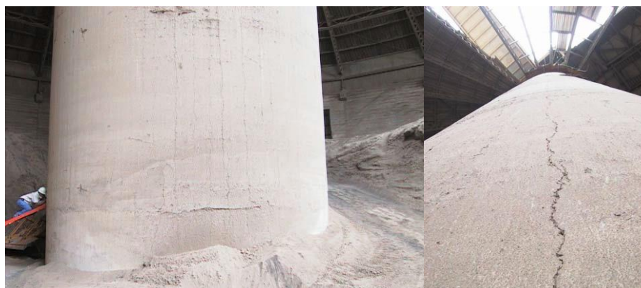
Figura 23 - Quadro de fissuração em silo de concreto armado.
