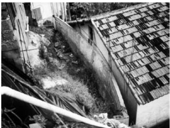
Figura 7 – Embarrigamento no pé do talude
