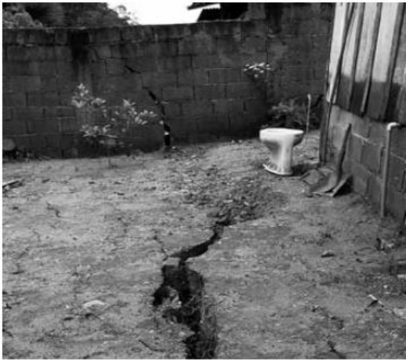
Figura 2 – Fendas no solo e fissuras nas paredes
