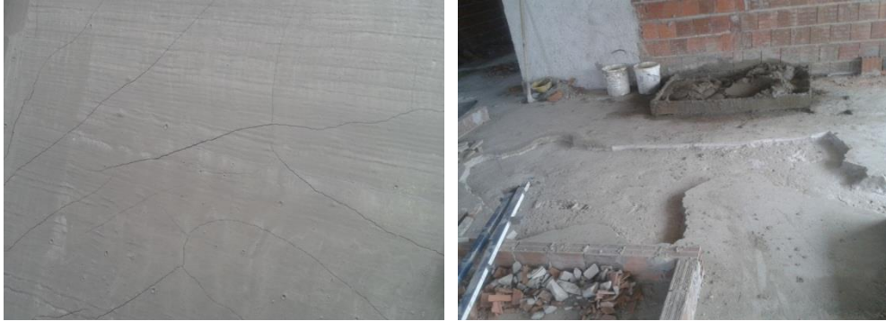
Figura 02 – Trabalho de correção no contrapiso que fissurou e fofou.
