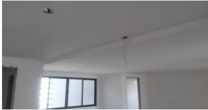
Figura 24 – Posicionamento incorreto de ponto de luz no forro da sala. Fonte: Autor.
