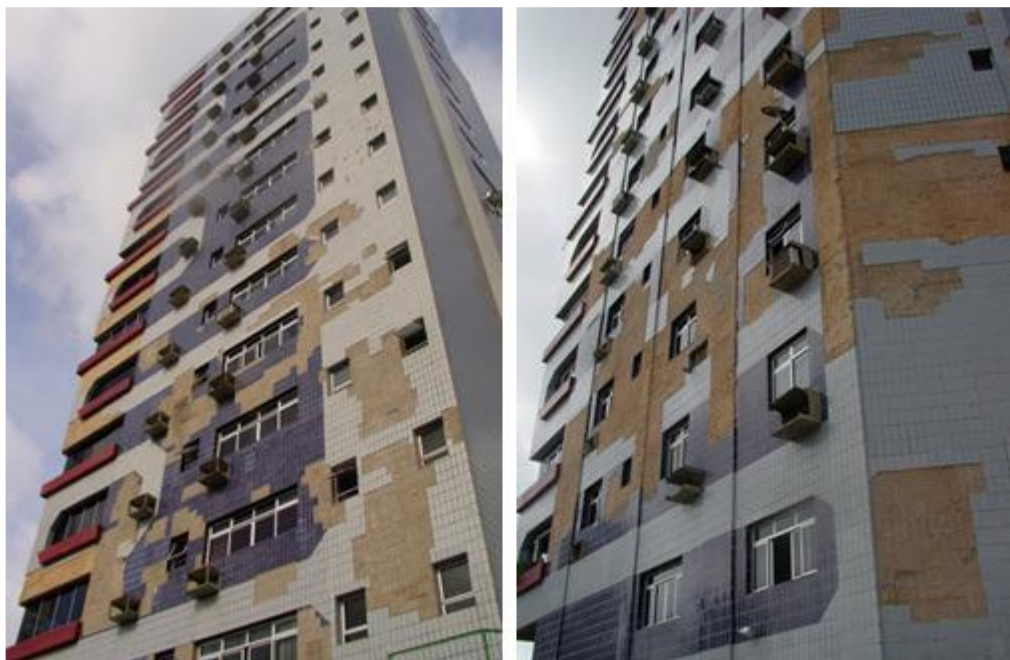
Figura 13- Destacamento ou descolamento do revestimento cerâmico de fachada
