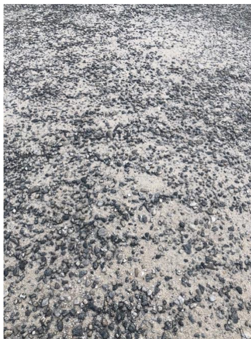
Figura 22. Desgaste do pavimento na Via Pau Brasil.
