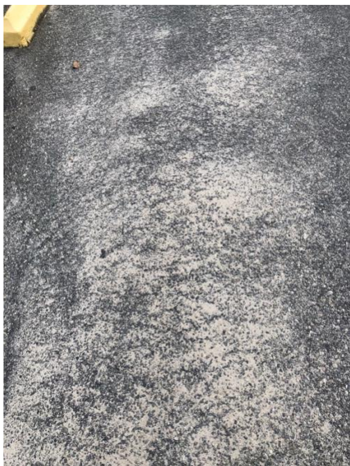
Figura 21. Desgaste do pavimento na Via Pau Brasil.
