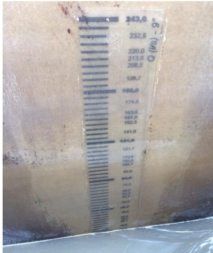
Figura 24 - Régua da Calha Parshal
