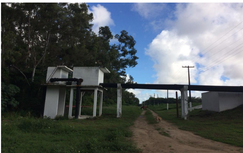
Figura 17 - Sistema de Alimentação
