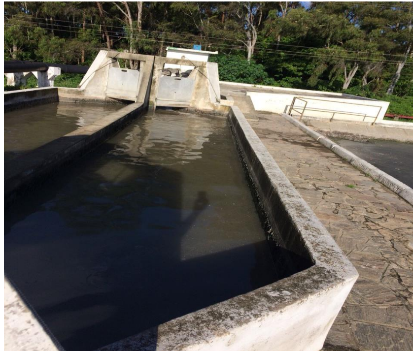
Figura 19 - Desarenador (Caixa de Areia)
