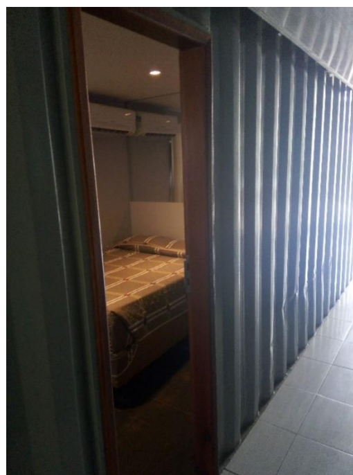
Figura 28 – Paredes do container com amassados à mostra
