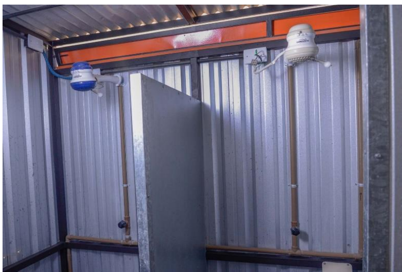
Figura 15 - Instalações hidráulicas de banheiro em containers
