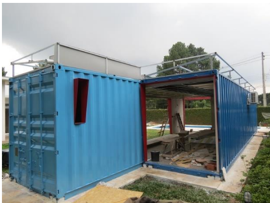
Figura 22 - Platibanda metálica em container
