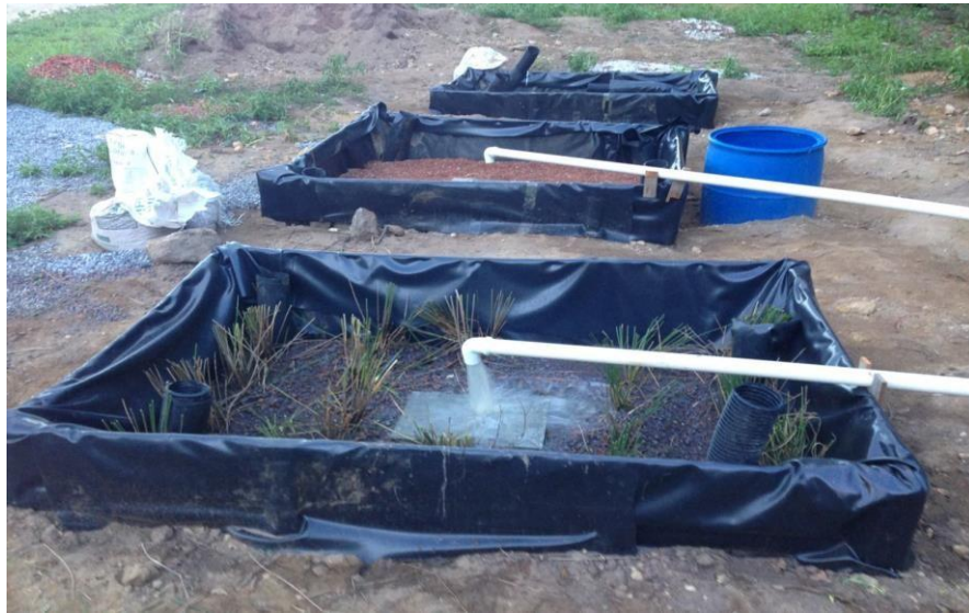
Figura 22 – Sistema Wetland em funcionamento
