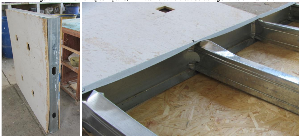
Figura 41: i -PSF 01 após ruptura, ii - Detalhe dos efeitos do carregamento em PSF 01.
