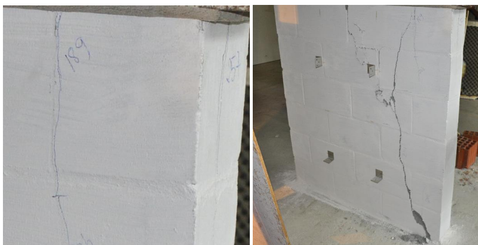
Figura 33: i - Primeiras fissuras em PBC 04, ii - Modo de ruptura da PBC 04.
