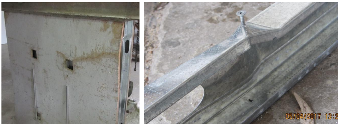
Figura 42: i - PSF 02 após ruptura, ii - Detalhe dos efeitos do carregamento em PSF 02
