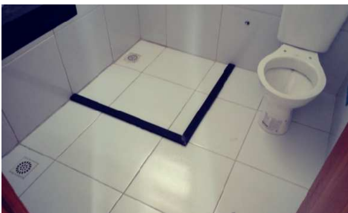
Figura 16 – Piso cerâmico do banheiro.
