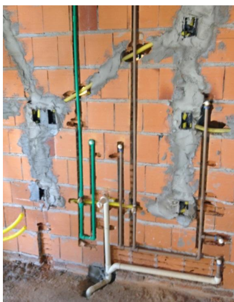
Figura 18: Interferências hidrossanitario e elétrico.
