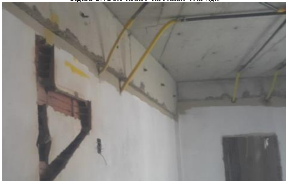
Figura 17: Duto elétrico em conflito com viga.
