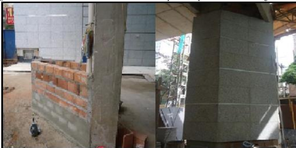
Figura 7: Pilar sendo revestido em alvenaria – à esquerda e pilar revestido com granito – à direita.
