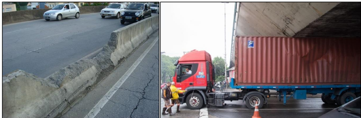
Figura 1 – (a) Guarda-rodas rompido por veículo. (b) Laje de viaduto danificada por choque de caminhão.
