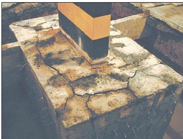
Figura 6 – Fundação atacada por RAA.
