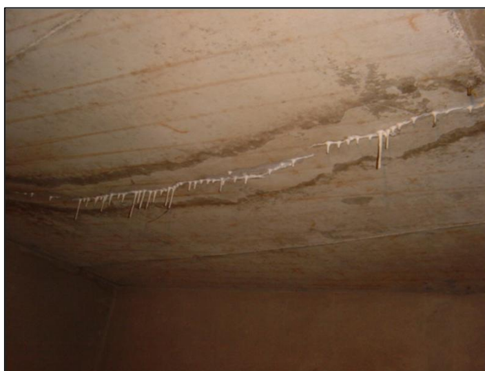
Figura 3 – Eflorescência em laje.
