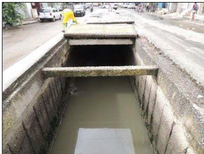
Figura 4 – Estrutura de canal atacada por sulfatos (certamente água com alto teor de sulfatos).
