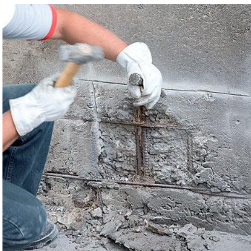
Figura 33 – Patologia por falha na execução
