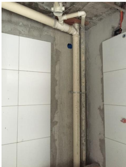
Figura 24 – Tubulação por fora da parede
