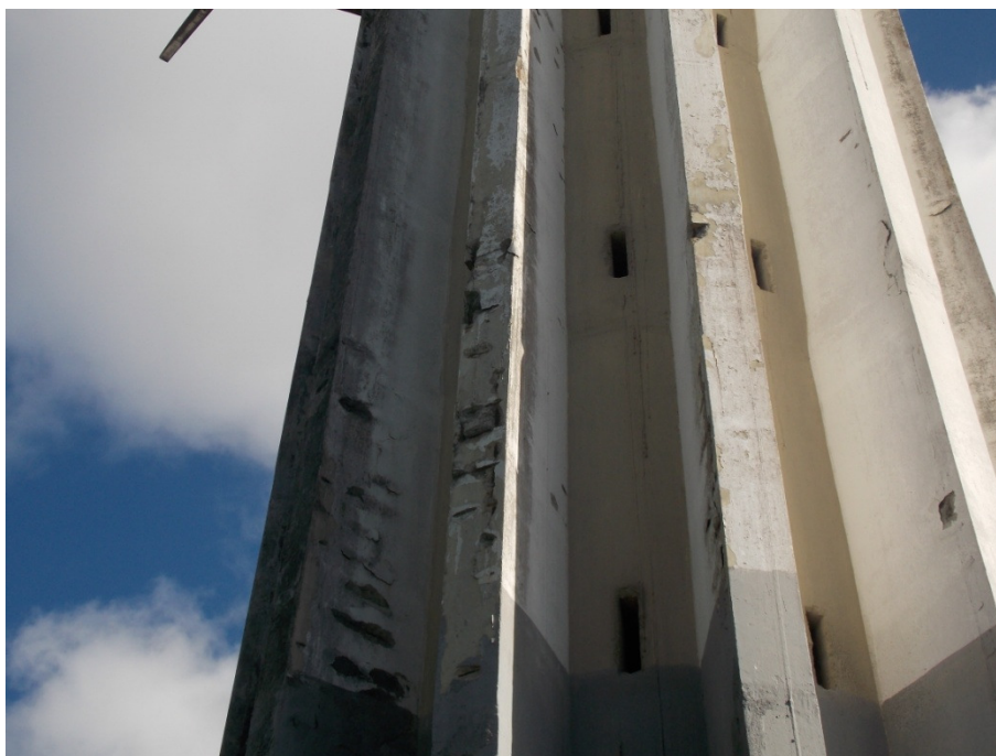
Figura 25- Reservatório R-5 com Ferragens à Mostra
