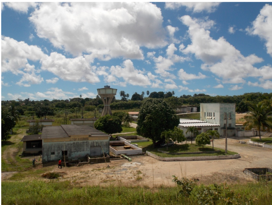
Figura 16 - Instalações ETA Marés.
