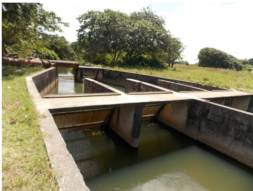
Figura 18 - Captação e Elevatória Gramame/Mamuaba.
