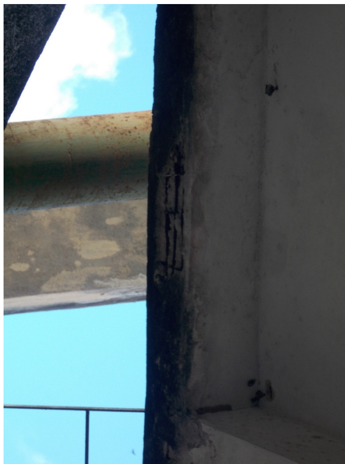
Figura 27 - Reservatório R-6 com Ferragem Aparente.
