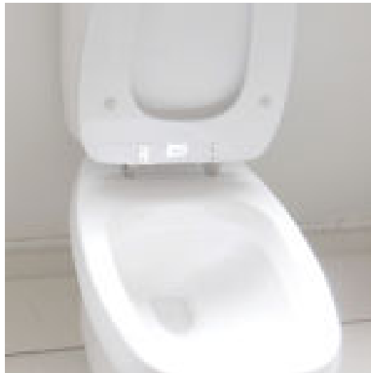
Figura 7 Vaso Sanitário sem sifão.
